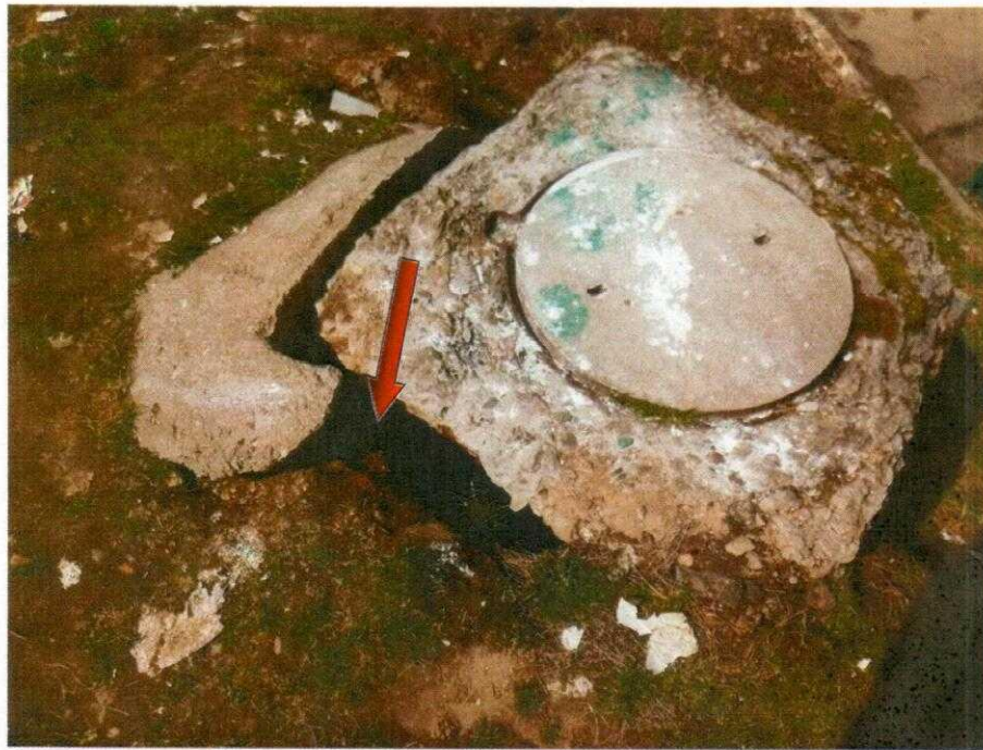
Фото 2.14. Канализационный колодец №2 (КК-2) (см. рис.2). Общий вид. Имеется разрушение конструктива колодца – в колодец может упасть, к примеру, ребенок – рядом находится тропинка к детской площадке;
