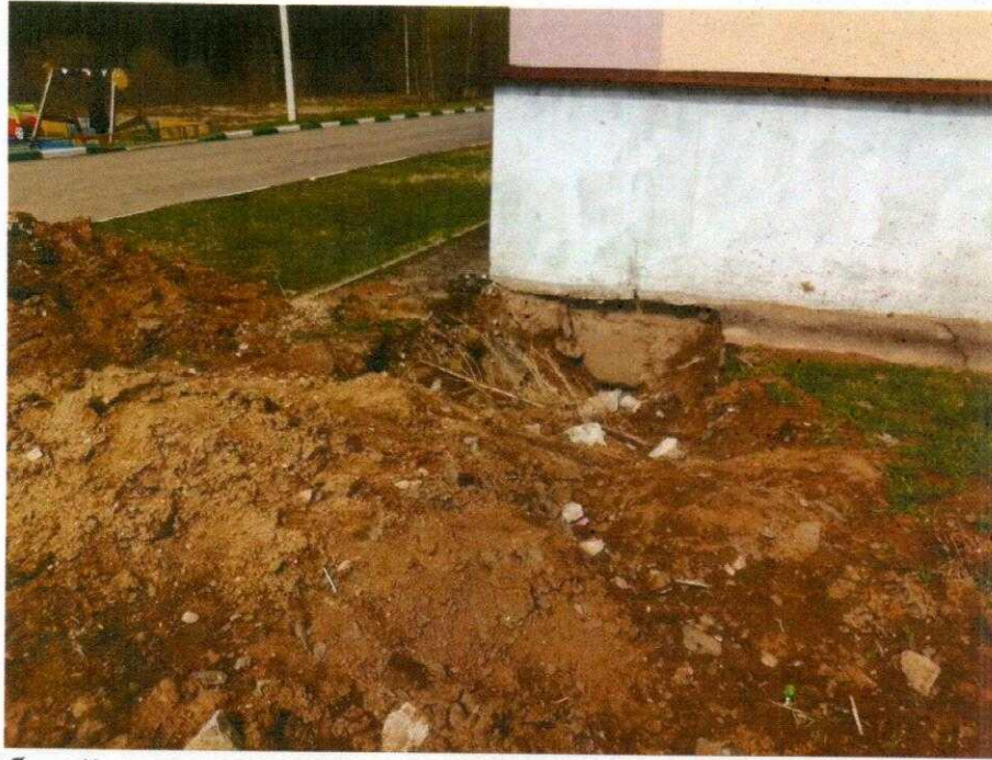
Фото 2.5. Общий вид в сторону дома Парковая, 1а. Имеются следы (вскрытие асфальта, земляные работы) после выполненного ранее ремонта сети от дома к колодцу КК-3, перекладки параллельной трубы ПВХ – благоустройство придомовой территории после ремонта не выполнено;
