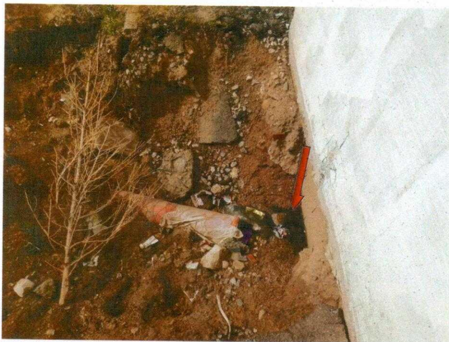
Фото 2.6. При перекладке трубопровода от дома к колодцу КК-3 выпускная труба к магистрали дома в подвале не подключена. Кроме этого, установлено, что из-за высокого уровня канализационных стоков в подвале через фундамент дома просачиваются стоки наружу – данный факт подтверждается на фото;
