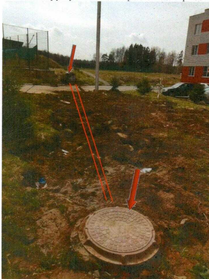
Фото 2.8. Канализационный колодец №3 (КК-3) (см. рис.1, 2) у дома Парковая д.1а. После параллельной укладки трубы ПВХ между колодцами КК3 и КК4 благоустройство придомовой территории не выполнено;
