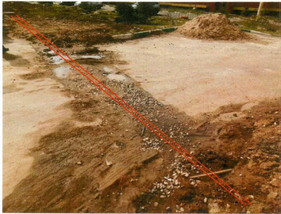
Фото 2.3. Общий вид от дома Парковая, 1а. Имеются следы (вскрытие асфальта) после выполненного ранее ремонта сети от дома к колодцу КК-3, перекладки параллельной трубы ПВХ – благоустройство придомовой территории после ремонта не выполнено;
