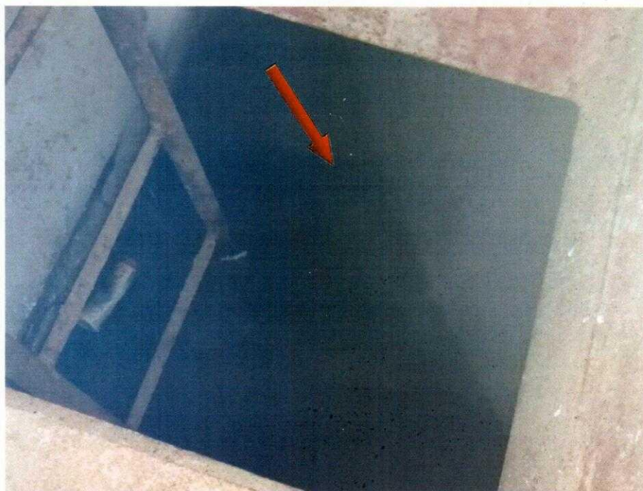
Фото 2.1. По состоянию на апрель 2022 года подвал дома Парковая, д. 1а затоплен канализационными хозяйственно-бытовыми стоками из-за отсутствия возможности удаления стоков (засора) от дома наружной сети канализации;
