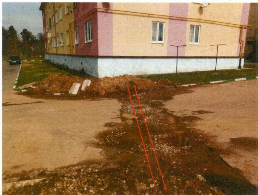
Фото 2.2. Общий вид в сторону дома Парковая, 1а. Имеются следы (вскрытие асфальта, земляные работы) после выполненного ранее ремонта сети от дома к колодцу КК-3, перекладки параллельной трубы ПВХ – благоустройство придомовой территории после ремонта не выполнено;
