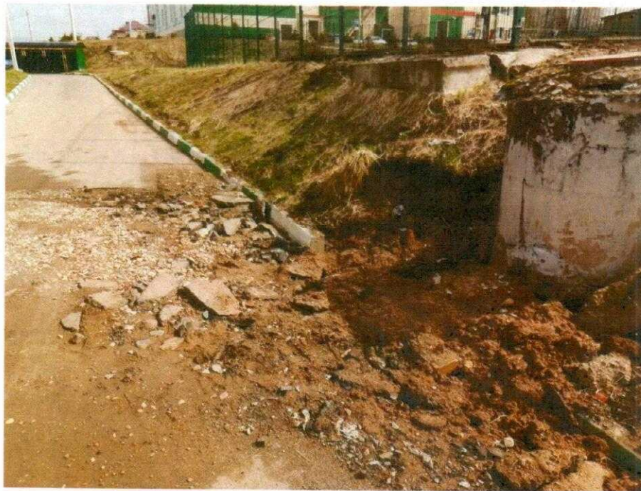
Фото 2.12. Канализационный колодец №4 (КК-4) (см. рис.2). Общий вид. Благоустройство придомовой территории после ремонта не выполнено;
