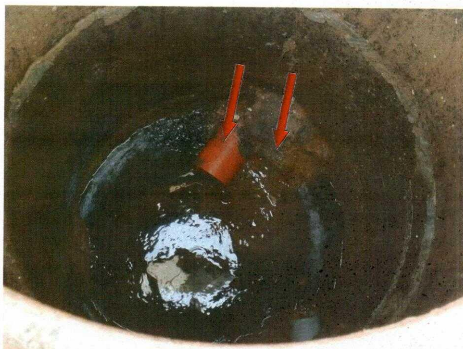
2.13. Канализационный колодец №4 (КК-4) (см. рис.2). Вид внутри. Выполнена параллельная дополнительная ветка неверно – Перекладка сети выполнена неверно, удаление стоков от дома Парковая, 1а не выполняется, в подвале дома по-прежнему присутствуют канализационные стоки. Требования Арбитражного суда Московской области по Делу №А41-28441/20 от 11 августа 2020 года (см. Приложение Г) не выполнено.
