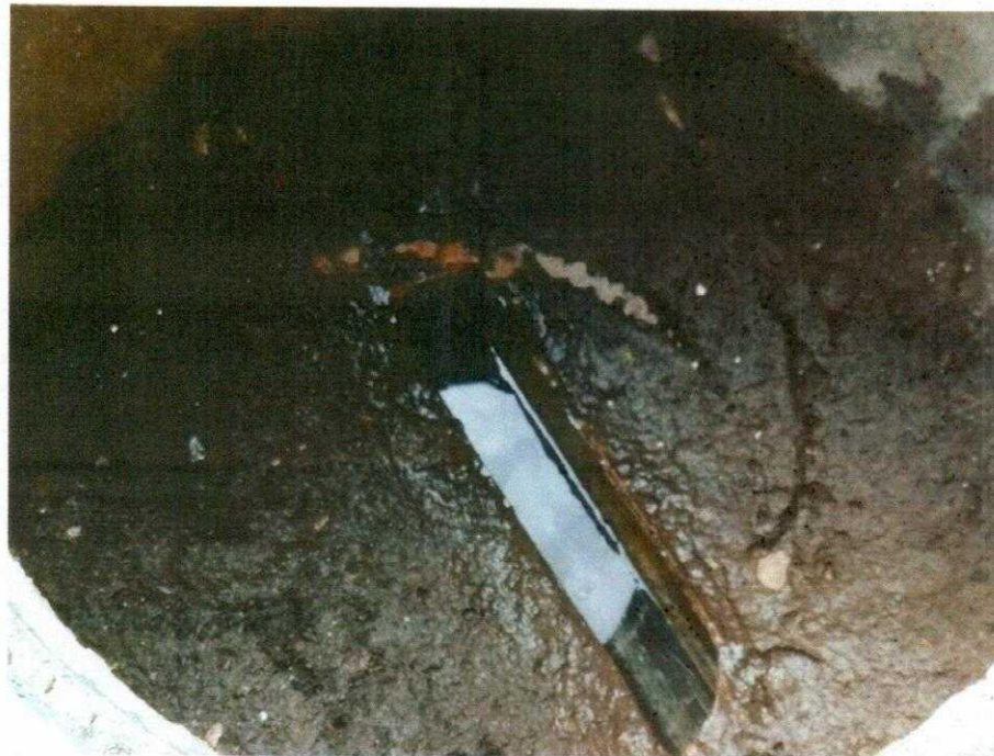
Фото 2.16. Канализационный колодец №5 (КК-5) (см. рис.1) у дома Парковая д.7. Вид внутри. Выполнено ревизионное отверстие не по регламенту. Глубина колодца – 0,530 м. В зимний период данный участок подвержен промерзанию;
