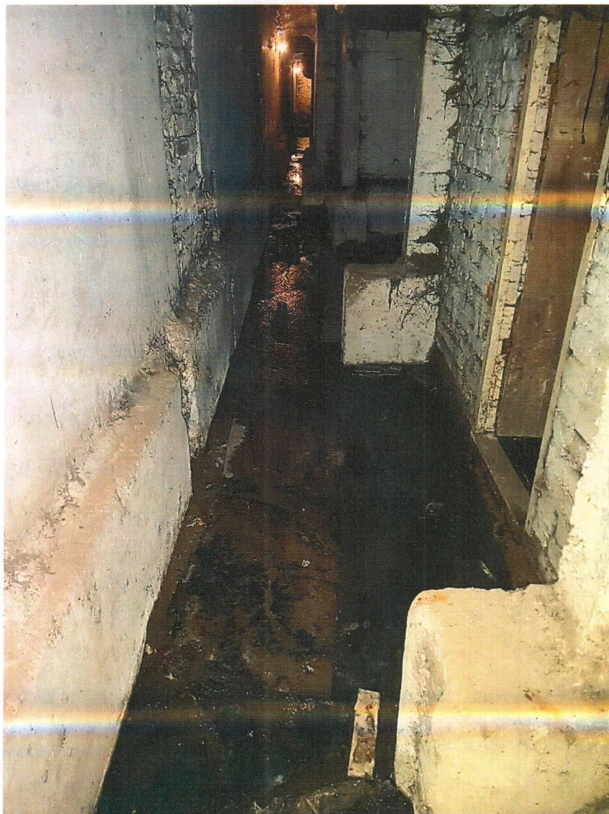
Фото 2.7. Подвал дома №26. Канализационные воды из-за засоренности магистральной наружной трубы от колодца №2 через технологические отверстия выливаются на пол подвала.
