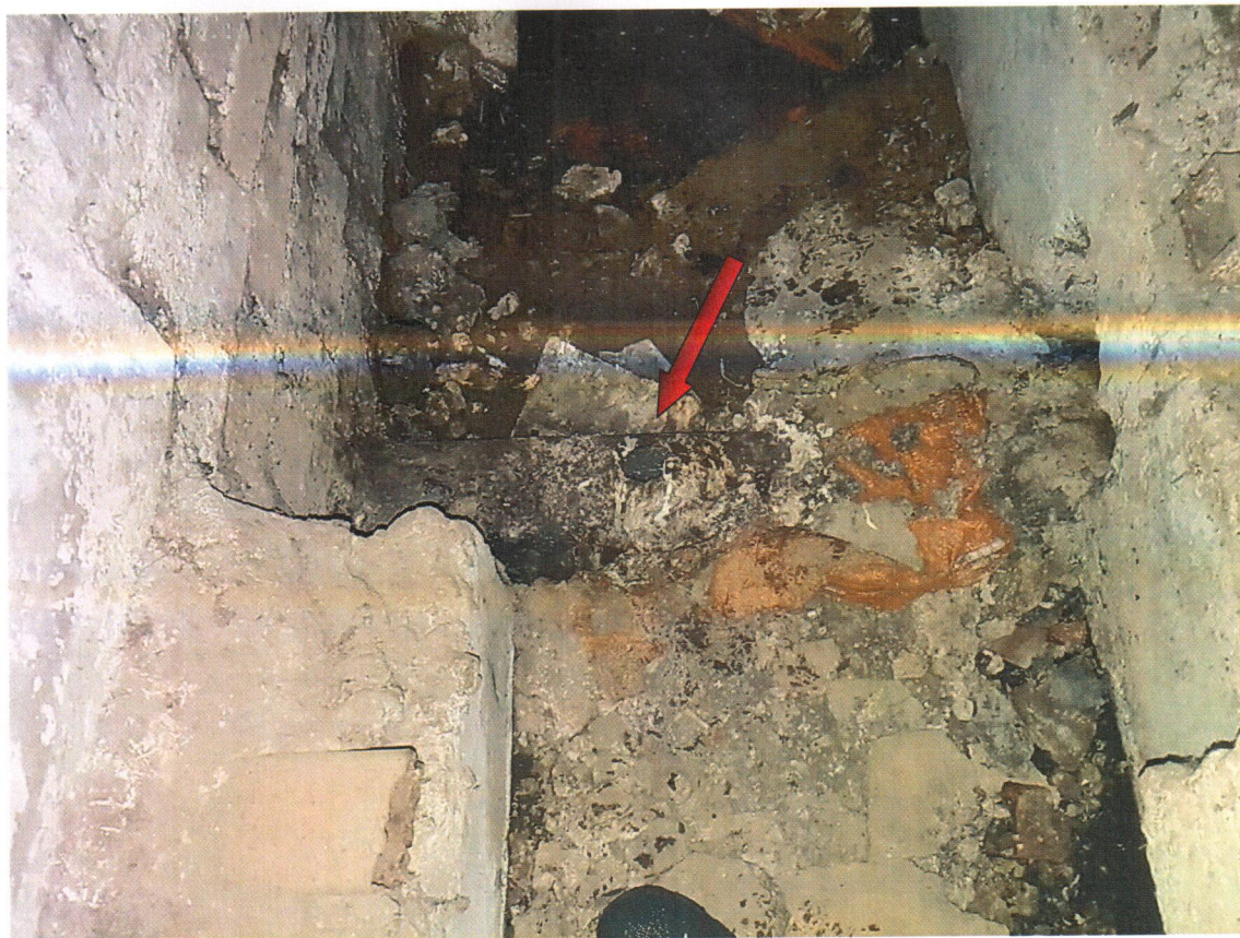
Фото 2.6. Канализационная труба в подвале дома №26. Сделано ревизионное отверстие для прочистки и предотвращения выдавливания стоков через унитазы первого этажа;
