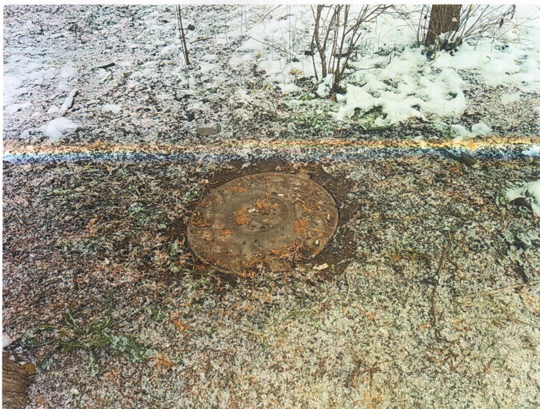
Фото 2.1. Канализационный колодец КК-1 (см. рис 1);
