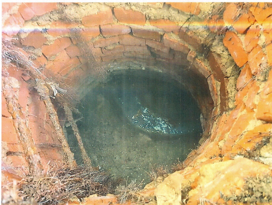
Фото 2.2. Канализационный колодец КК-1. Отсутствует движение жидкостей;
