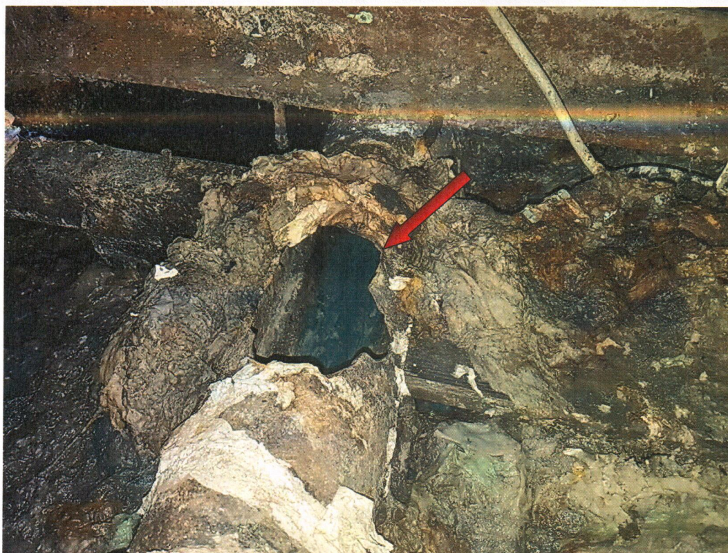
Фото 2.4. Канализационная труба в подвале дома №26. Сделано ревизионное отверстие для прочистки и предотвращения выдавливания стоков через унитазы первого этажа;
